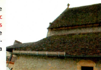
Détail de la toiture en mauvais état
