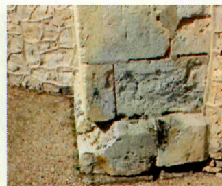
Des pierres de façades détériorées
